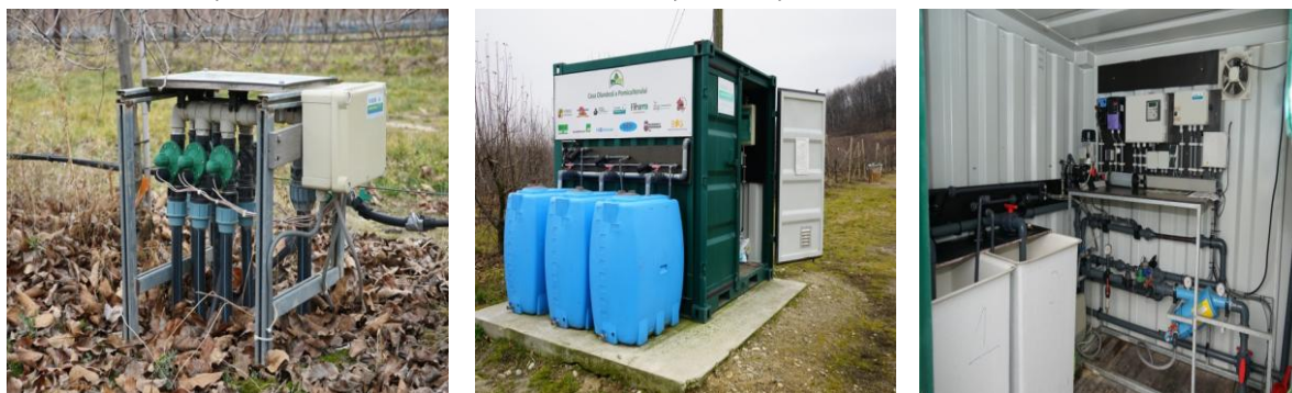
Fig. 9. Sistem automatizat de control al fertirigării (Sursa: Chțu E., original)
