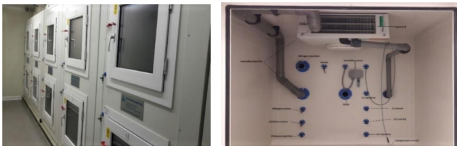
Figura 3.1. Celulele cu atmosferă controlată exterior (sânga) și interior (dreapta)
